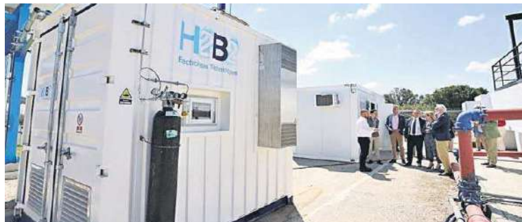
La nueva planta ya se encuentra operativa.
