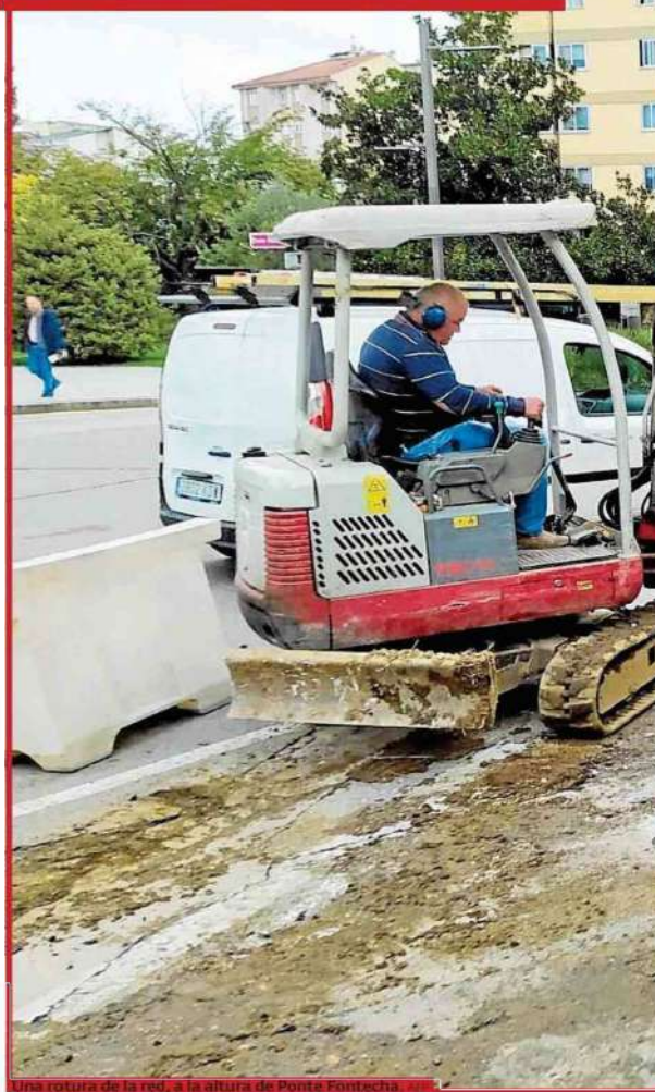
Una rotura de la red, a la altura de Ponte Fontecha.
