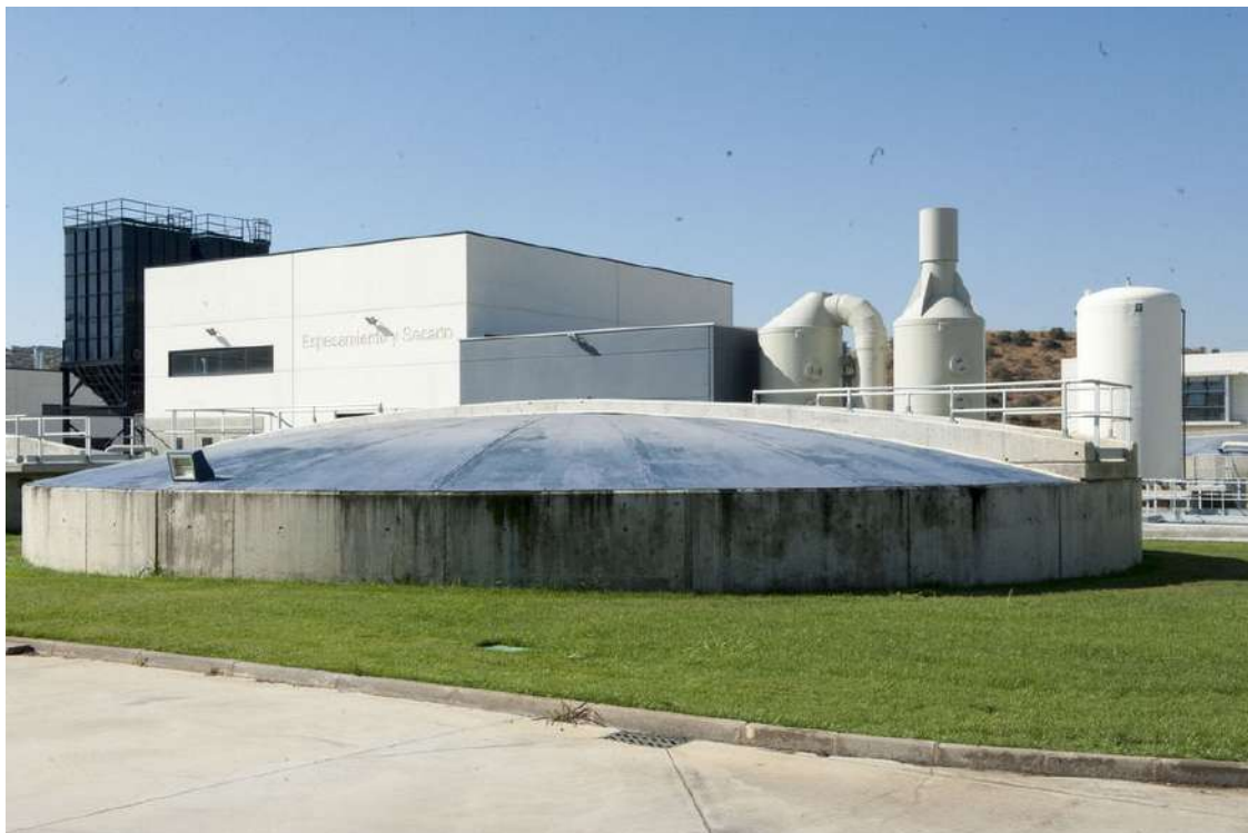
La depuradora de Estiviel, una de las tres ubicadas en Toledo - Foto: Yolanda Lancha
